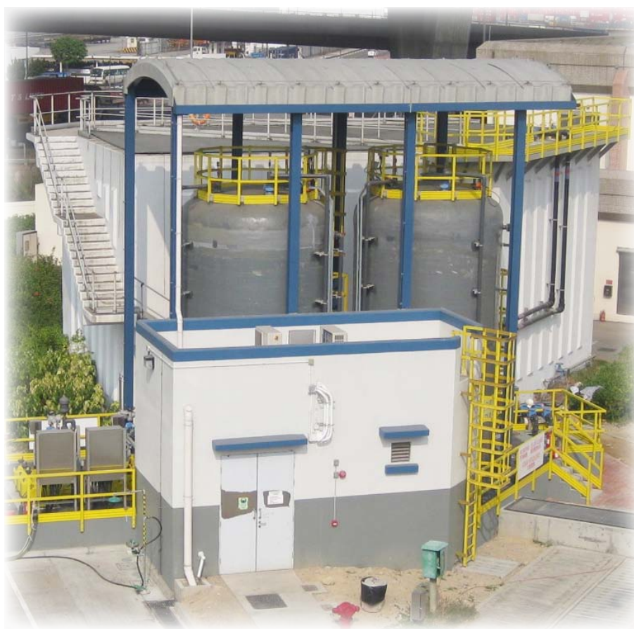
位於昂船洲污水處理廠的前期消毒設施 於 2010 年 3 月全面啟用
