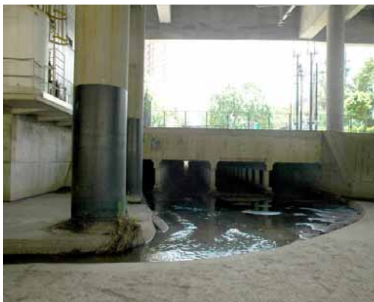
屯門河上游（TN1）監測站受到無污水渠的鄉村影響，河道裡可見到糞便淤泥積聚。
