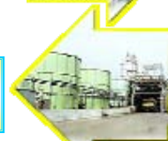
新界西堆填區的臨時隔油池廢物處理設施
