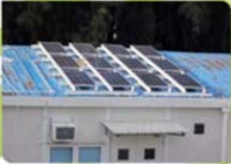
屋頂太陽能板 4
