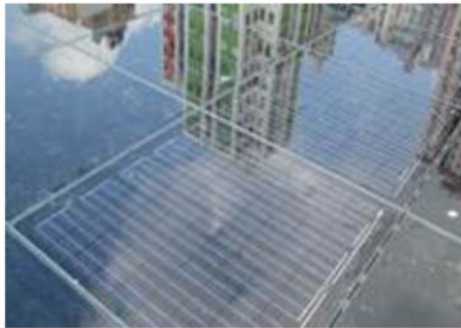
附設於建築物光伏系統的光伏板
