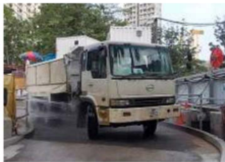
地盤出口的輪胎清洗設施
