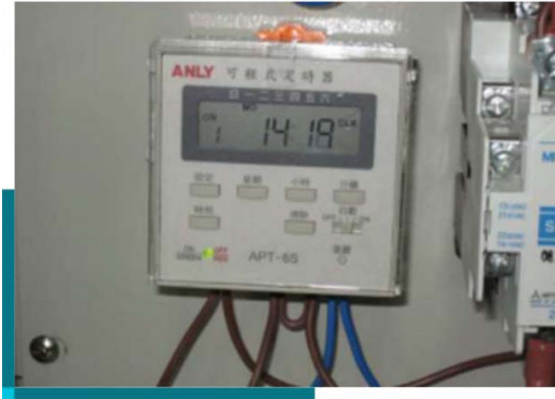
為非必要電插座供電安裝定時器控制
