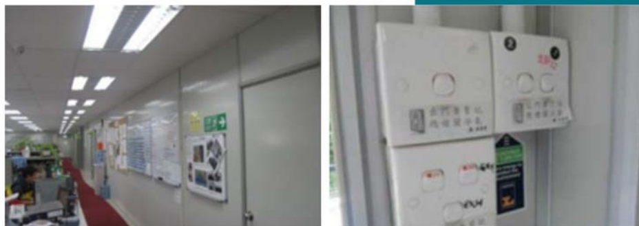
採用高能源效益的T5光管及LED燈，另設「分區」電燈開關
