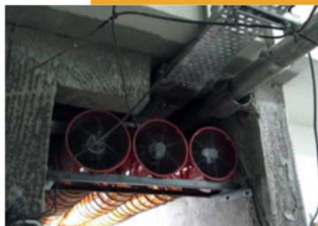
地庫安裝鼓風機加強通風
