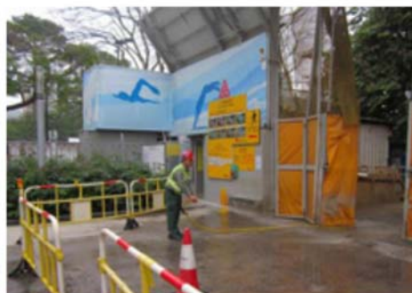
工地入口的噴霧灑水系統
