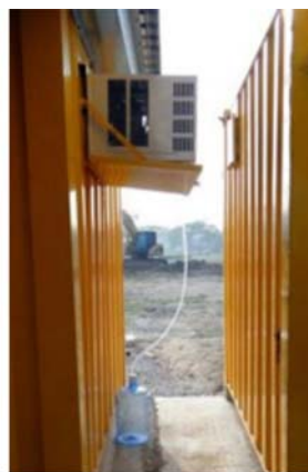
收集空調機滴水循環再用
