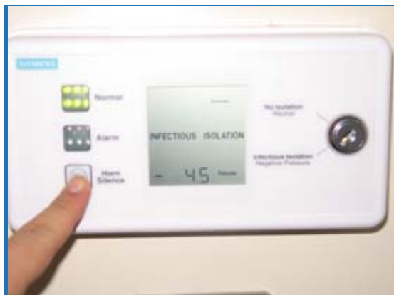
樓宇用後評估小組進行現場考察時，檢查醫院內隔離室及候見室的風量差壓
