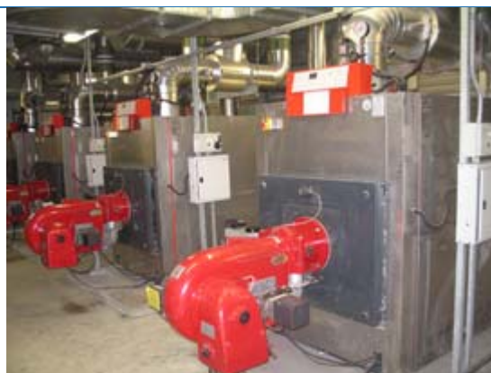
樓宇用後評估小組檢查瑪嘉烈醫院新傳染病大樓的冷凝式燃氣熱水鍋爐的運作
