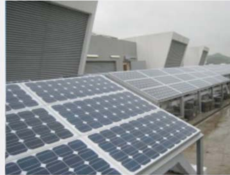
太陽能光伏板供電系統
