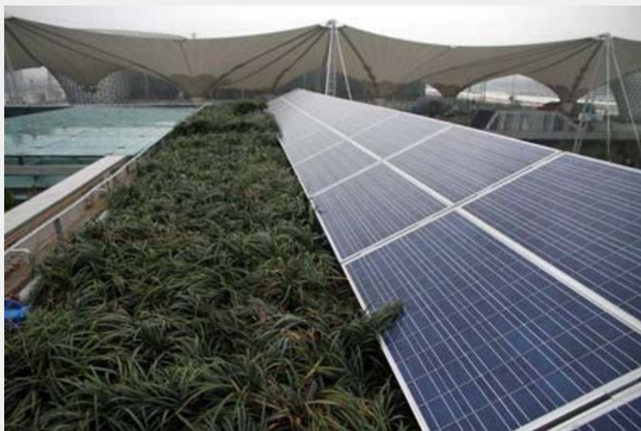
綠化屋頂及太陽能光伏板
