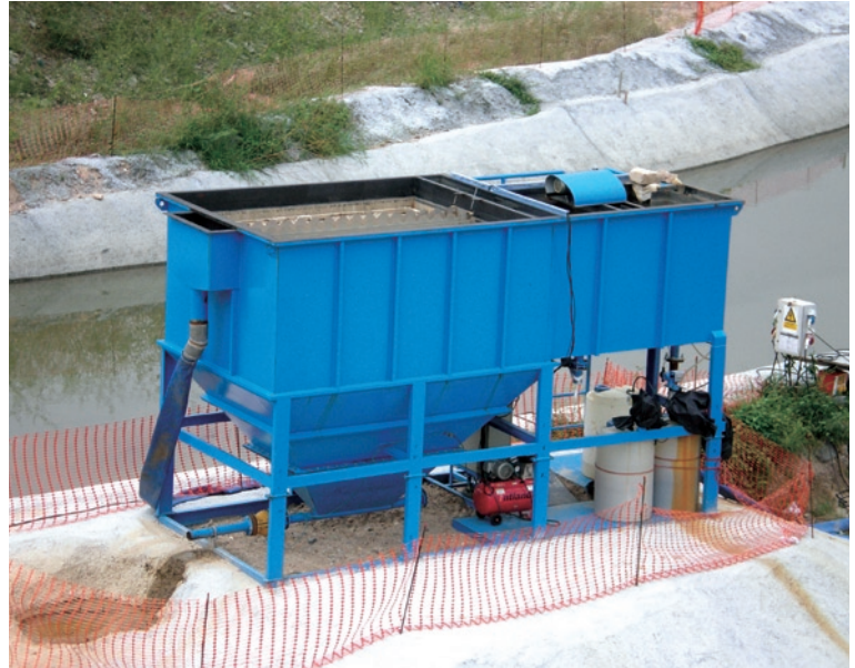
利用沉澱池處理地盤產生的廢水 Sedimentation tank to treat the wastewater generated on site
