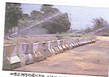
在斜坡安裝的噴水系統，以減少揚塵。 Water spraying system on slope to reduce dust.
