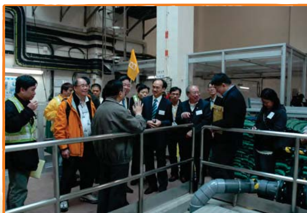
區議員參觀大坑東蓄洪池
