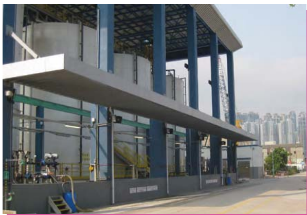
昂船洲污水處理廠的消毒設施
