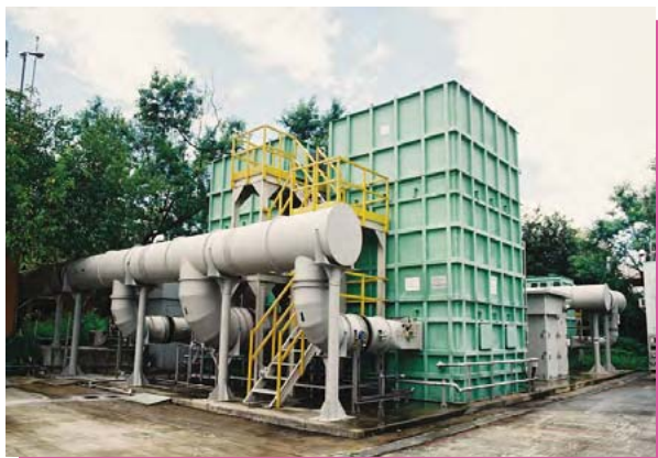
沙田污水處理廠的除味機組
