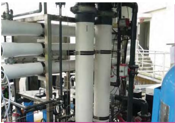
西貢污水處理廠的超過濾裝置
