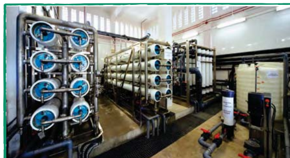
位於沙田污水處理廠再造水資訊中心旁的經處理污水再造機組
