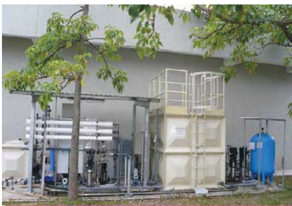
元朗污水處理廠的逆滲透裝置
