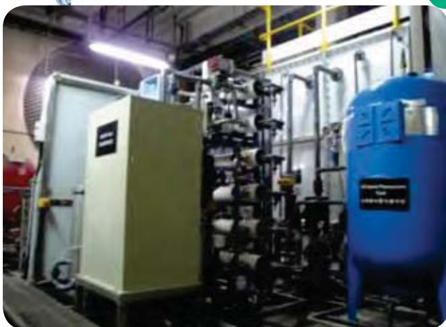
赤柱污水處理廠的逆滲透裝置
