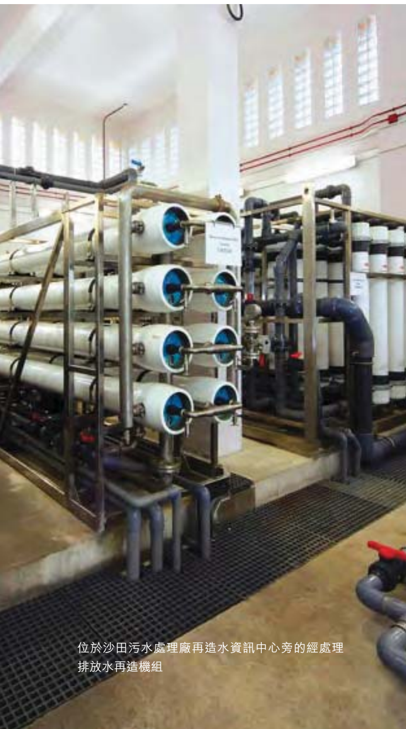
小蠔灣沙田污水處理廠的再造水設施
