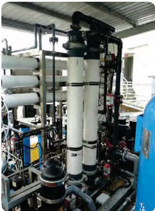
西貢污水處理廠的超過濾裝置
