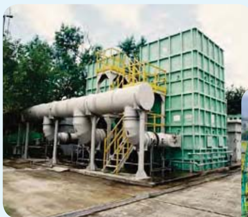
沙田污水處理廠的除氣味機組
