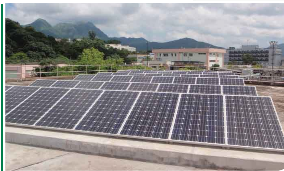
● 在元朗污水處理廠天臺上的6.3千瓦太陽能光伏板 6.3 kW PV Solar Panel on the roof of Yuen Long Sewage Treatment Works
