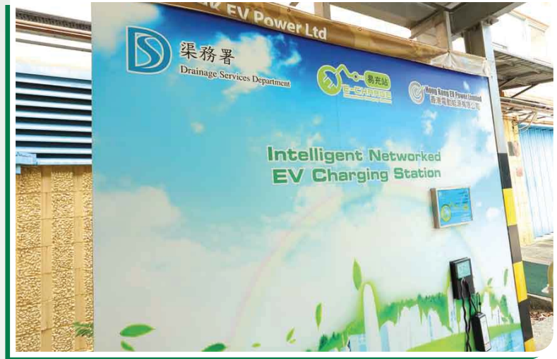
◆ 在沙田污水處理廠內的電動車充電站 Electric vehicle charging station at Shatin STW
