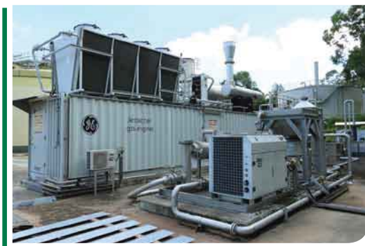
● 沙田污水處理廠的熱電聯供發電機 Combined heat and power generator at STSTW
