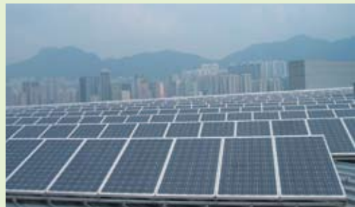
於總部大樓的太陽能光伏系統
