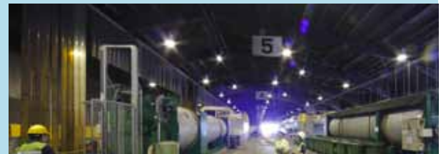
廚餘經預處理後，會送進堆肥裝置處理。
