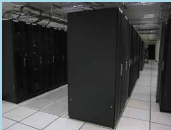
伺服器架以「熱廊」和「冷廊」方式排列
