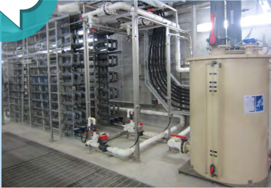
海水泵房內的電解產氯裝置。
