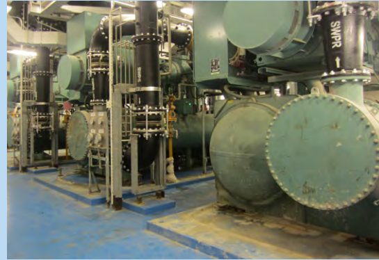
添馬新政府總部大樓的中央冷凍機房。
