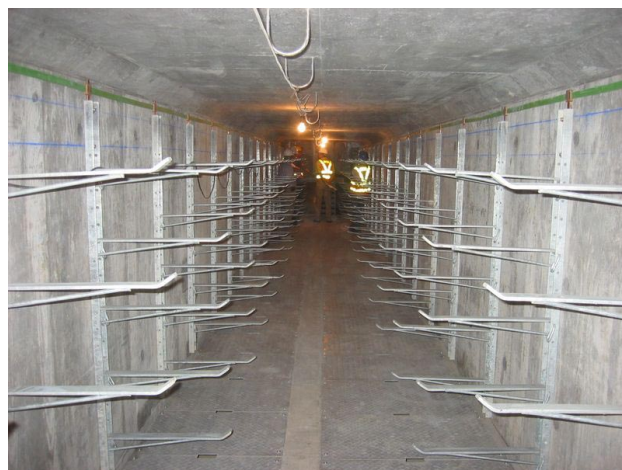
位於欣翔道的公用設施共用管道
