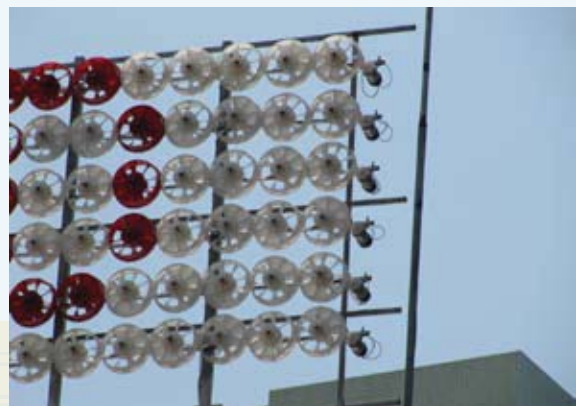
在駐工地總工程師辦事處安裝的微型風力發電系統
