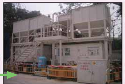
廢水處理系統
