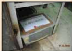
化學物防漏裝置
