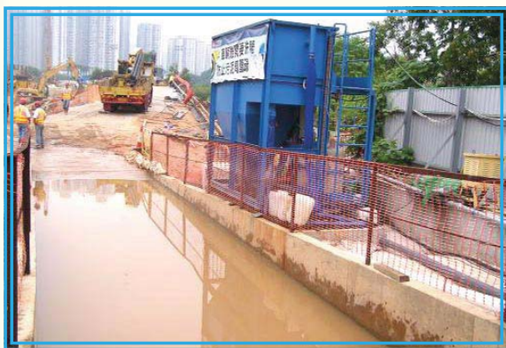
工地上的廢水處理設施
