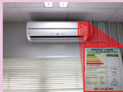
工地辦公室的冷氣機附有能源效益標籤計劃下的一級能源效益標籤
