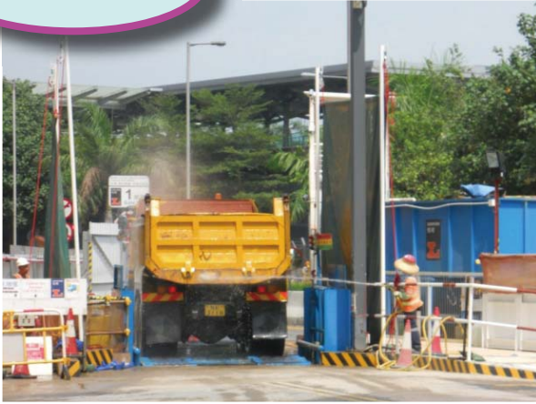
工地的自動車輪清洗機
