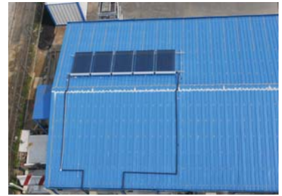
工地熱水爐的太陽能電池板
