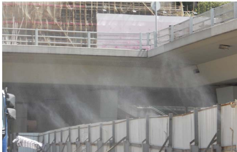
沿工地圍板安裝的防塵灑水系統
