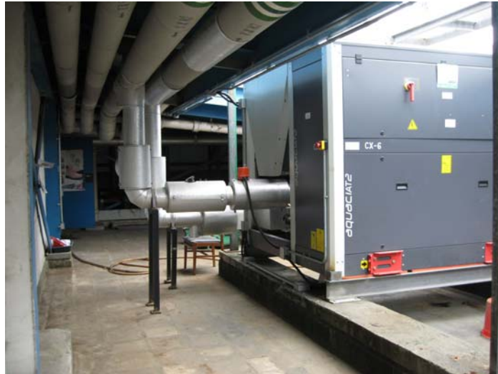
空調機組所用的全新節能製冷機
