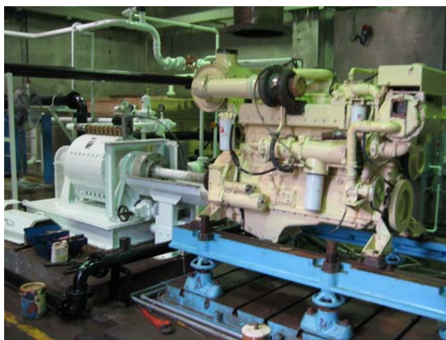
為監察輪機廢氣排放情況而新設的煙氣分析系統
