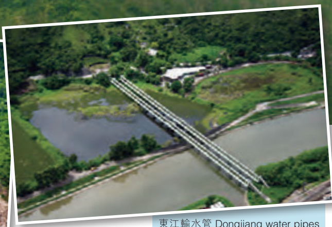
東江輸水管 Dongjiang water pipes
