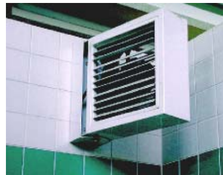
維多利亞公園內，安裝於公共廁所內的太陽能驅動抽風扇。
