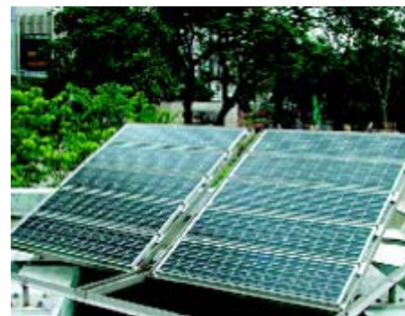
維多利亞公園內，安裝於公共廁所天台的太陽能板。
