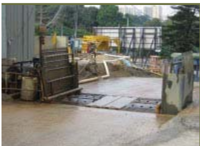
工地入口處的污水過濾再用設備和自動清洗輪呔系統
