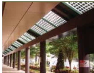
青山醫院行人道上蓋安裝的太陽能光電板
