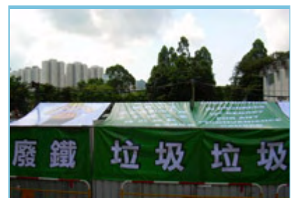
提供工地廢物分類設施
