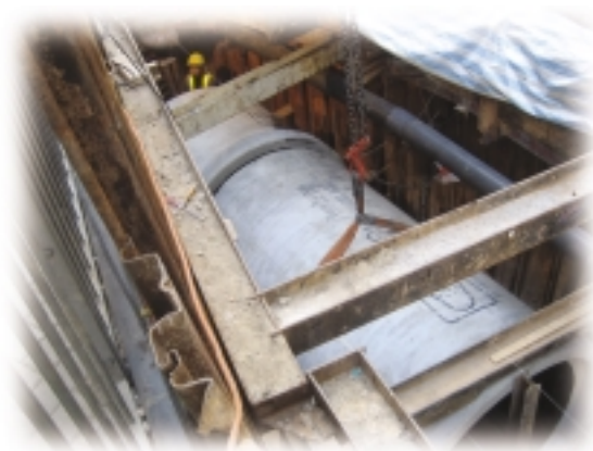
皇后大道中正敷設直徑1500毫米的混凝土排水管，以解決上環的水浸問題
