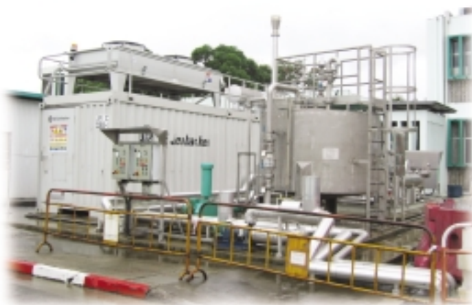
石湖墟污水處理廠的電熱聯供沼氣發電機
