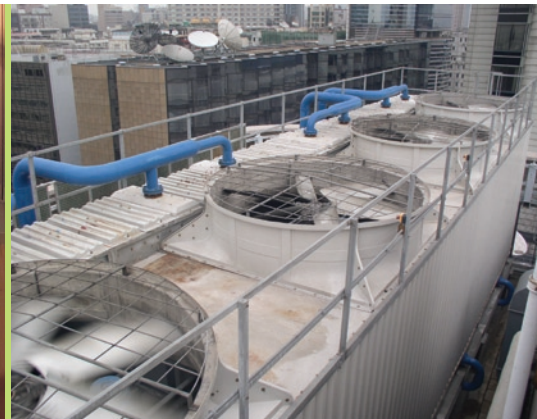
安裝於尖沙咀基督教青年會的冷卻塔
