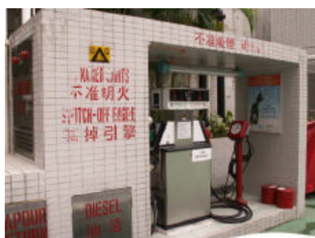
安裝在消防局 / 救護站的汽油加油站之汽體回收系統
