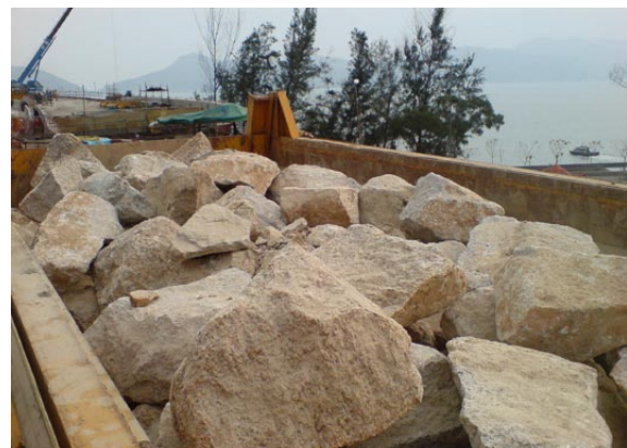
循環再用在工地上打碎至標稱尺寸700級石填料的岩基和巨礫，以建造海堤墊層
