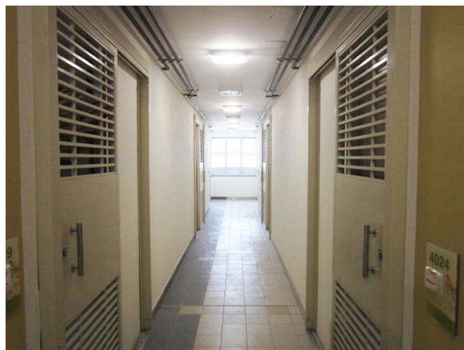
啟晴邨的LED照明裝置
