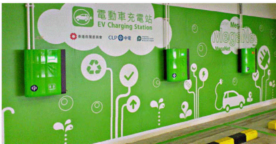
彩德商場停車場的電動車充電設施
