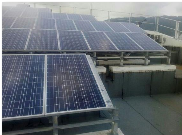
啟德第一甲區的的太陽能光伏板
