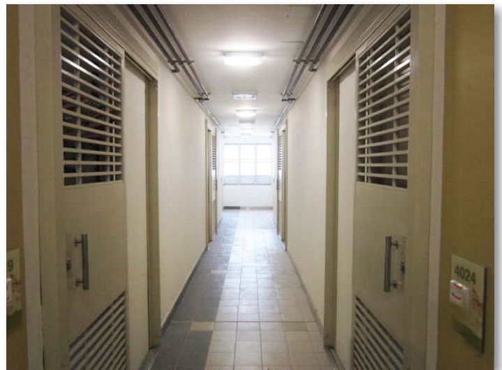
啟晴邨的LED照明裝置
