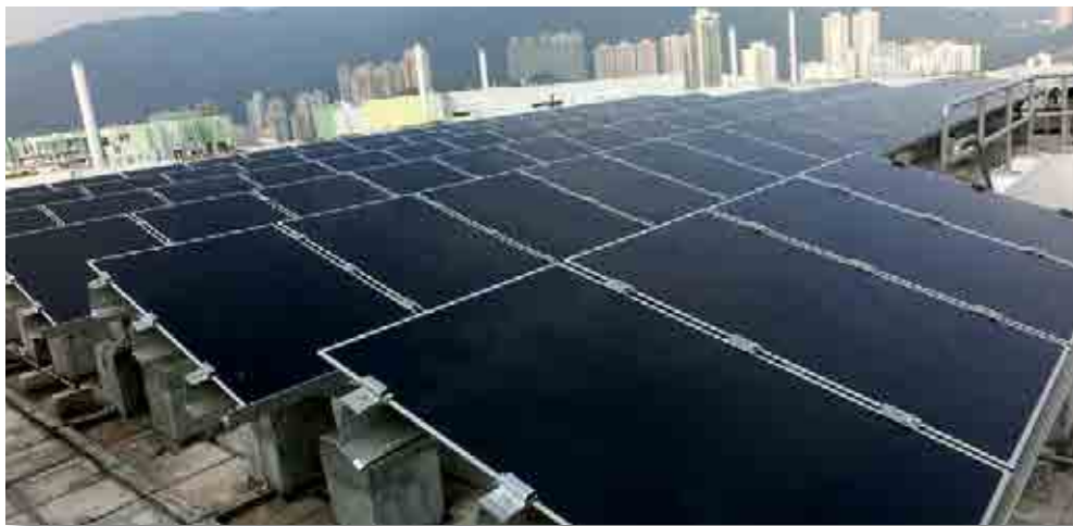
啟德第一乙區的太陽能光伏板
