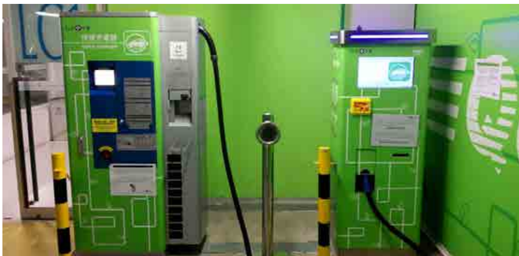
油麗商場停車場的電動車充電設施
