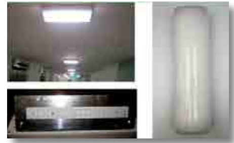
啟德第一甲區試驗安裝LED凸面照明器
