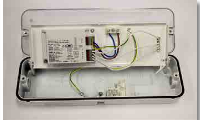
葵盛西邨的電子鎮流器凸面照明裝置
