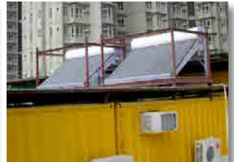
工人淋浴間安裝太陽能熱水器
