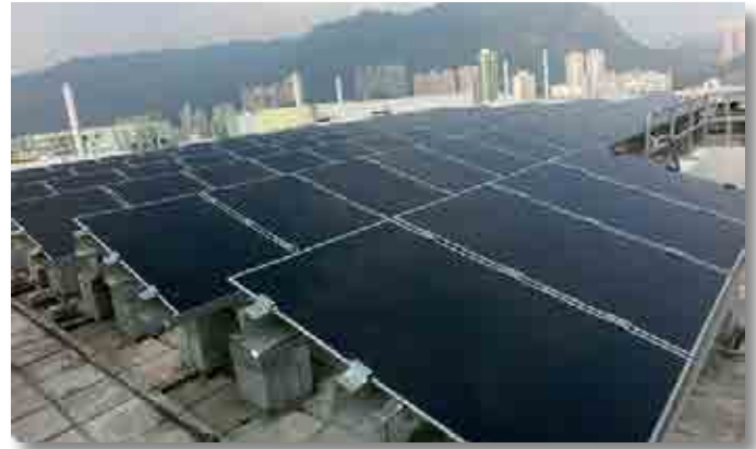
啟德第一乙區的太陽能光伏板
