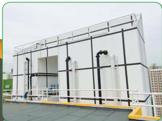
安裝於油麗邨天台的「雙水缸供水系統」
