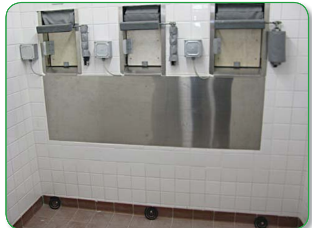
東區海底隧道第5期屋邨的郵筒型垃圾桶(攝於垃圾房內)
