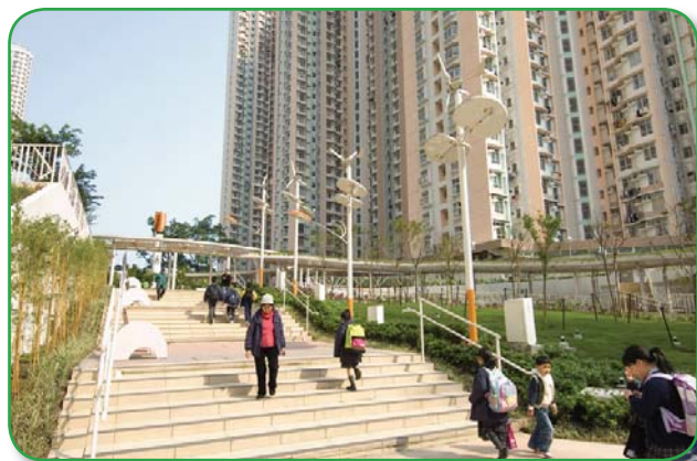
秀茂坪南邨以風力及太陽能混合發電的戶外照明系統
