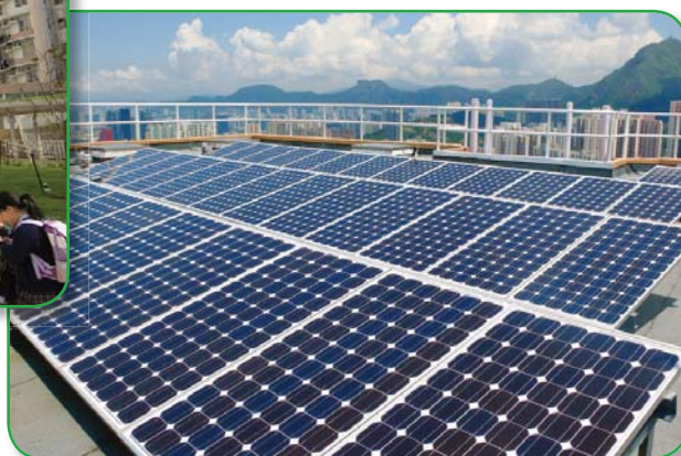
在藍田邨接駁至電網的太陽能電池板
