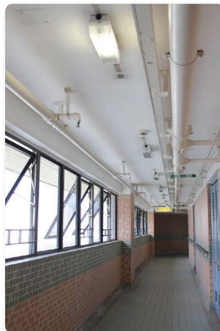
何文田邨走廊改良照明系統後，日間可選擇性地關掉電燈
