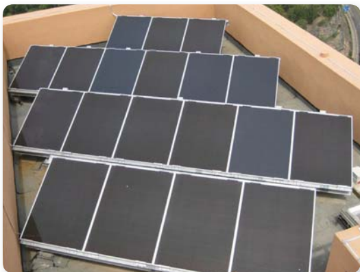
東區海底隧道第五期屋邨的非晶硅薄膜
