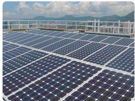
藍田邨的公共電網光伏系統
