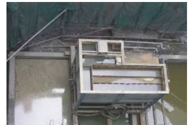
廢水處理系統
