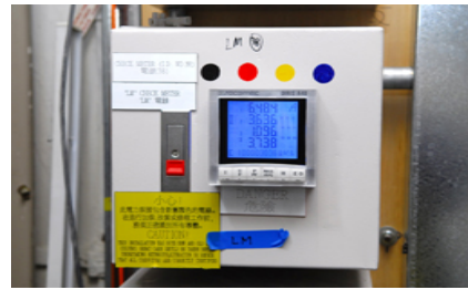
裝設電錶以監察每個樓層的耗電量。
